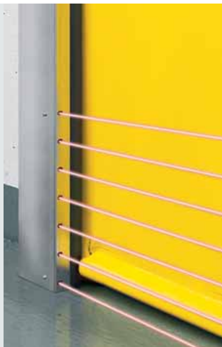
Světelná závora namontovaná ve vedení vrat
