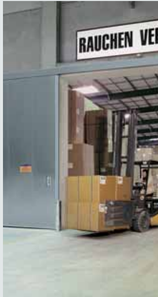
6 Protipožární posuvná vrata
